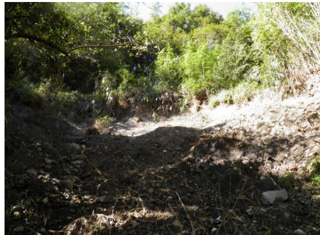
写真2 崩壊斜面の下部から滑落崖の状況
