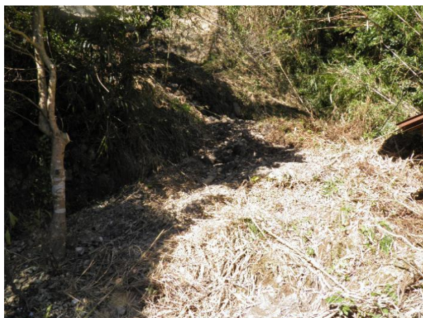
写真5 住宅裏の崩土
