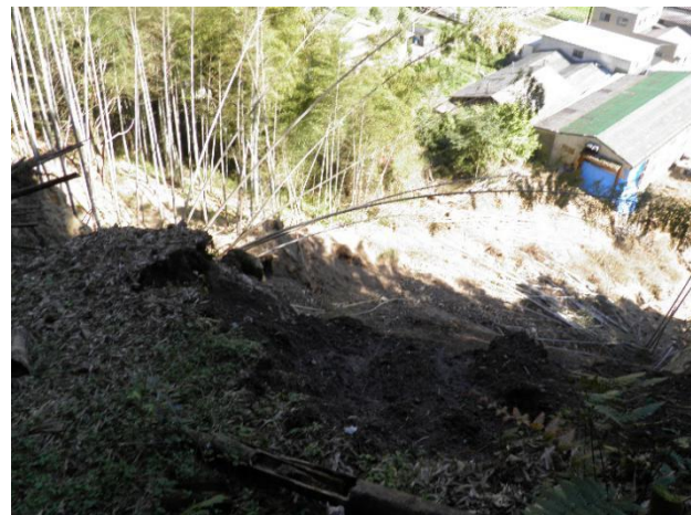
写真4 少し離れて隣接する崩壊の状況
