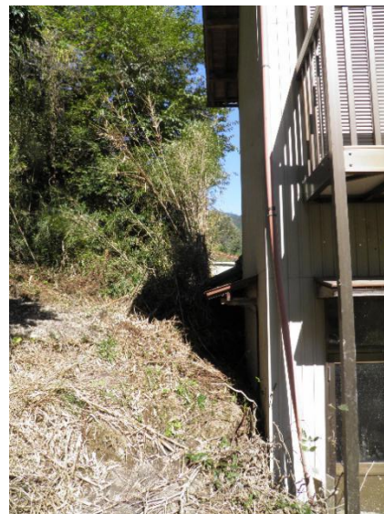
写真6 住宅裏の崩土
